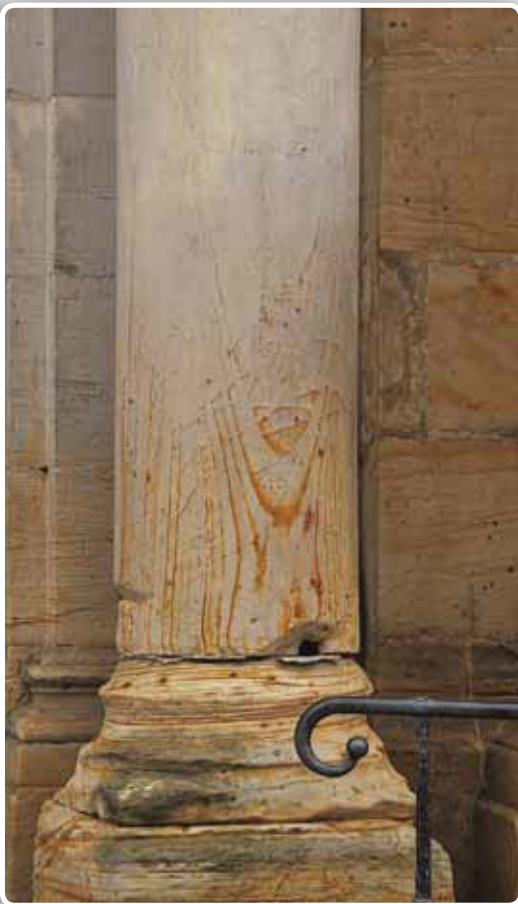
Bild 6 Säule rechts des Haupteingangs der Basilika. Bleiweißanstrich und Sandsteinsockel sind stark angewittert.
