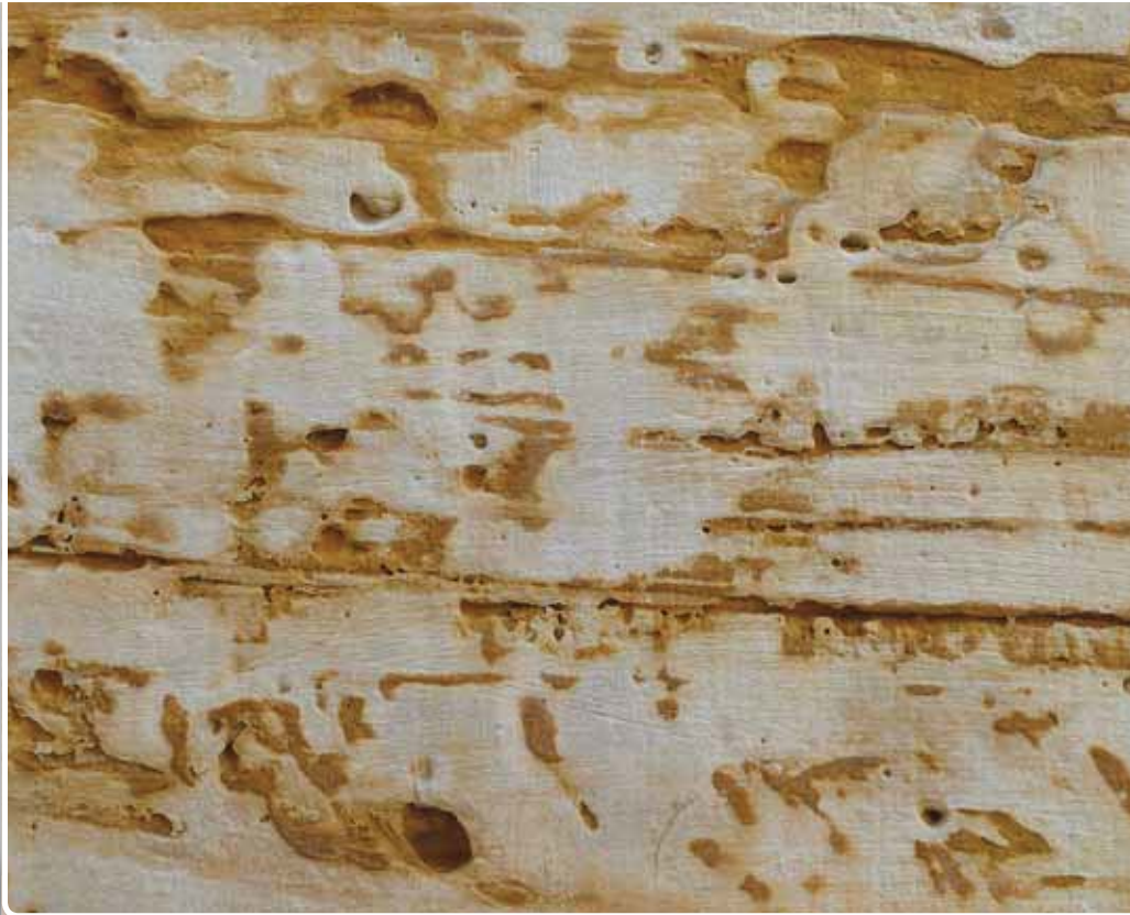
Bild 6 Der weiche, feine Eisensandstein an der Basilika ist stellenweise rostfarben limonitstreifig und stark angewittert. Bildbreite: 40 cm.
